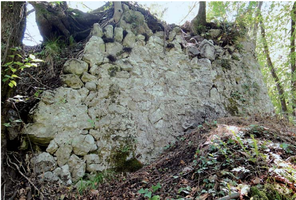
Fig. 13 - Il tratto murario perimetrale nordovest, con fessurazioni verticali sulla superficie.
