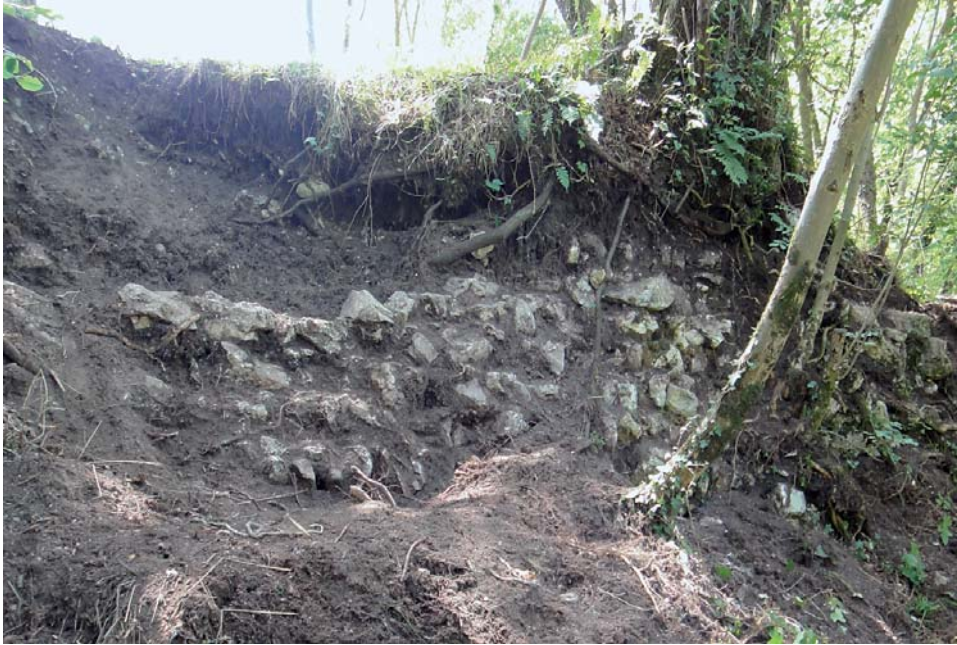
Fig. 14 - Il tratto murario perimetrale nord, privo del paramento esterno.
