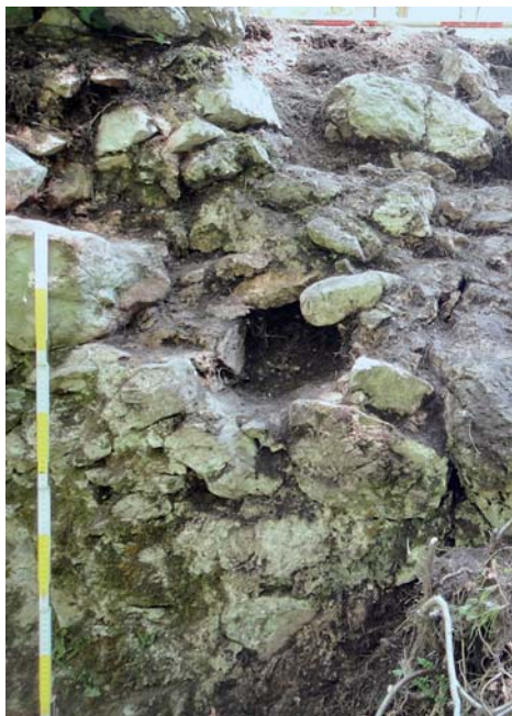
Fig. 18 - Lacuna presente all'estremità meridionale del muro perimetrale nordovest.
